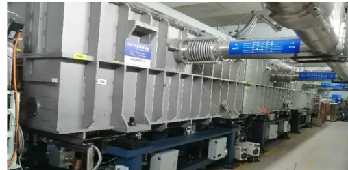
连续波超导直线加速器 (CW-LINAC)
